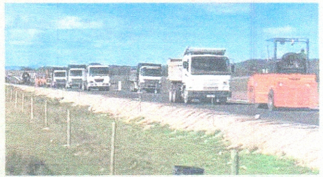
PADWERKE: Volgens die Overberg Distriksmunisipaliteit sal die opgraderingswerk aan die ou grondpad tussen Bredasdorp en Uitenhage in Junie voltooi wees. Die 20 km teerpad tussen Boordkloofdorsbas en Elm is reeds voltooi. Die laaste fase van die projek strek oor ongeveer 30 km van Afdelingspad 1205, vanaf die Uitenhage-oorbrug tot in Elm. Junie maand is gereserveer vir die aanbring van padverfmerke, padlakens en afrandings aan die pad-reserwe (die gedeeltes tussen die teerwerk en die draadswaai). Die foto toon die samestelling van die teer-terrein wanneer bitumen gespuut en klipsterwe gestrooi word met die aanbring van 'n Koupepe seël.
