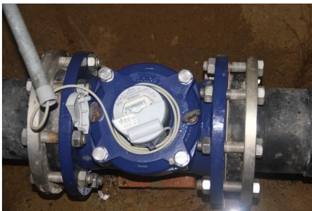
Bulk outlet flow meter for Rooi Els reservoir
